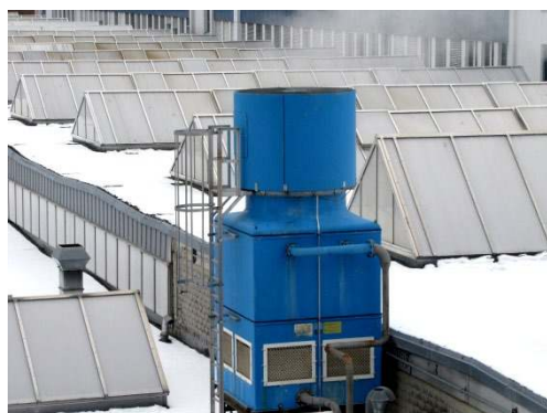
Beispiel eines in der Industrie eingesetzten Kühlturmes
